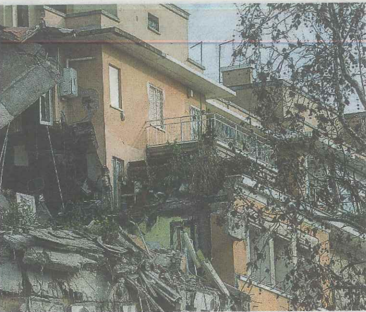
Flaminio Il palazzo parzialmente crollato il 22 gennaio scorso a lungotevere. Flaminio: ospita il teatro Olimpico, già riaperto
